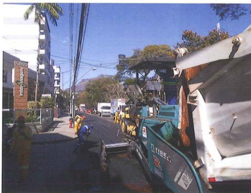
Figura 133 Equipe da concessionária prossegue com os serviços de recapamento asfáltico na RJ 116
