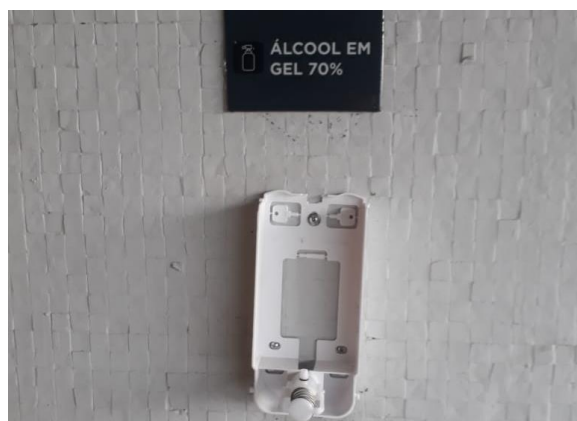
Figura 30 – Recipiente de Álcool em gel vandalizado no mezanino da estação Japeri
