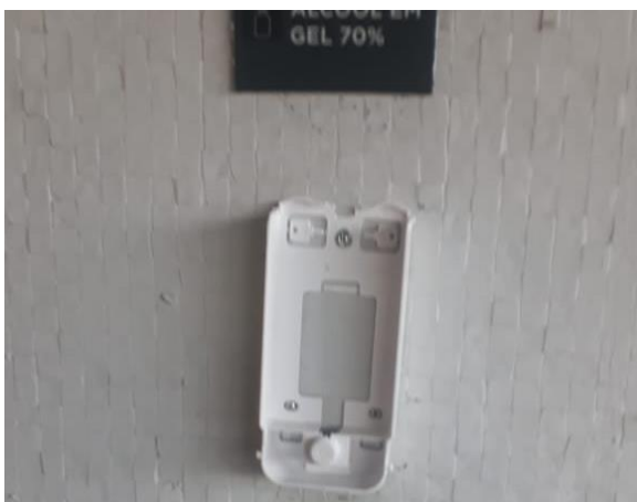
Figura 45 – Recipiente de Álcool em gel vandalizado no mezanino da estação Japeri
