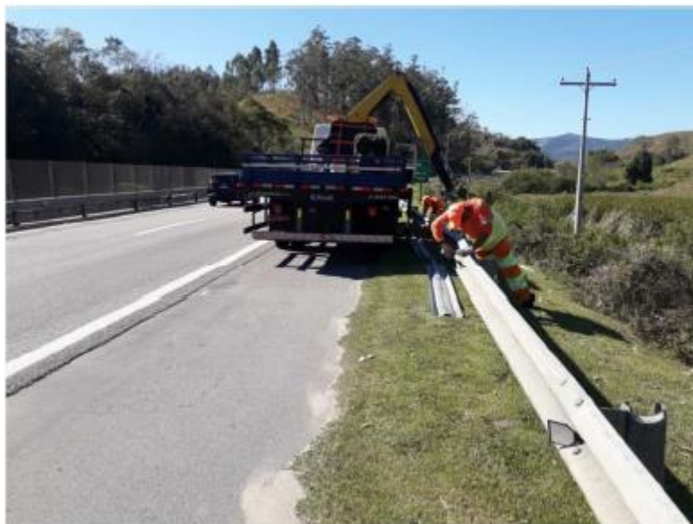
Figura 113 Reparo de guia de segurança
