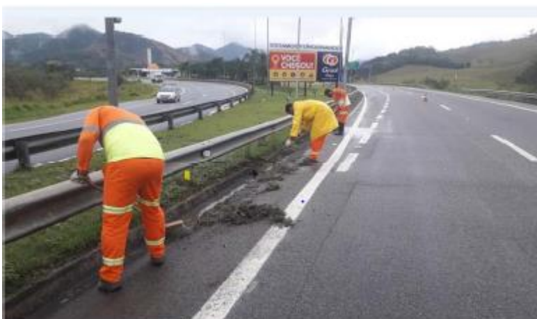
Figura 116 Limpeza de Sarjeta
